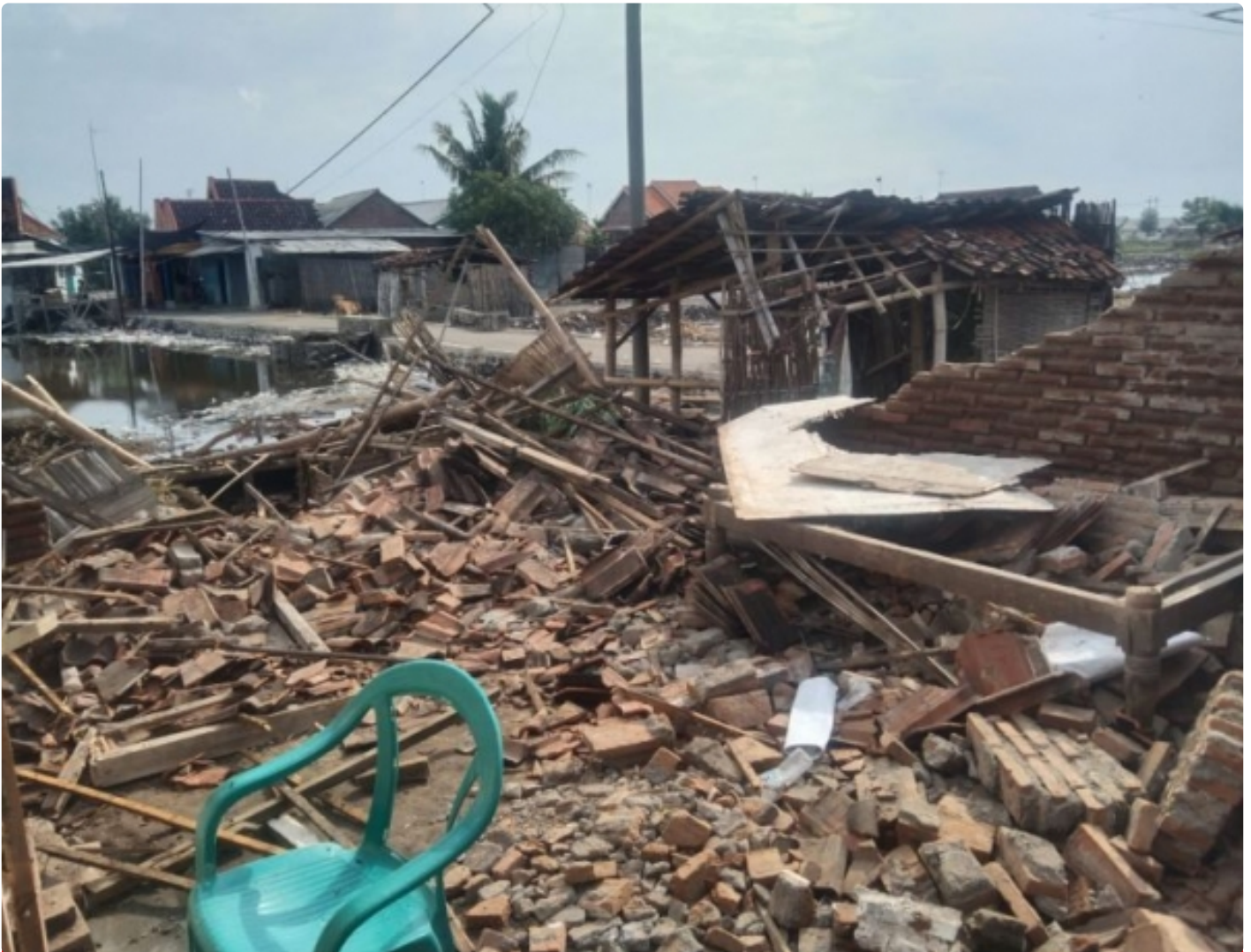
Kondisi rumah Ibu Niah warga Karanganom, Karanganyar, Paiton, Probolinggo setelah di terjang angin
